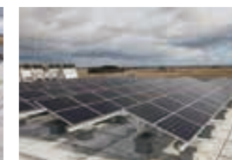
屋上に設置された太陽光発電パネル。災害時の非常電源としても利用されます。
