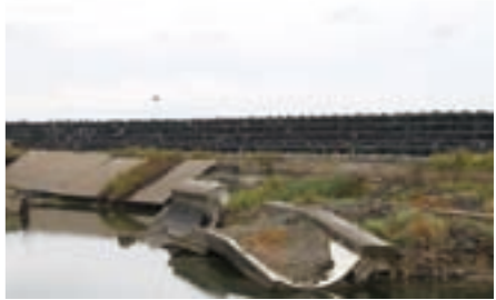
早期の復旧が望まれる堤防
