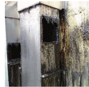
排出口の油汚れ
