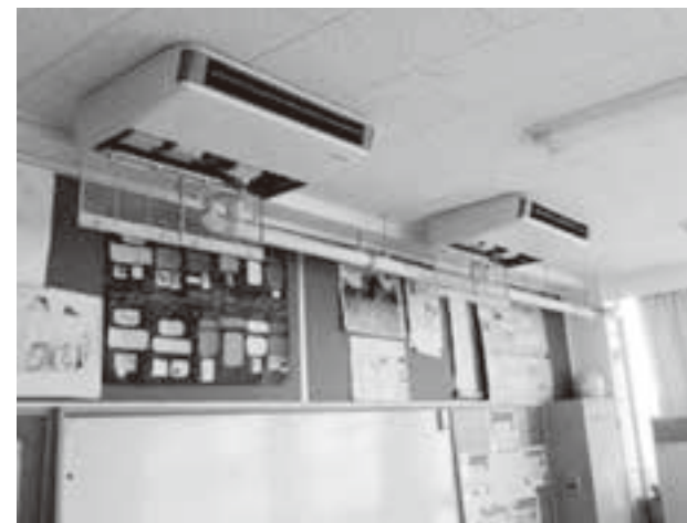
学校に設置されたエアコン
