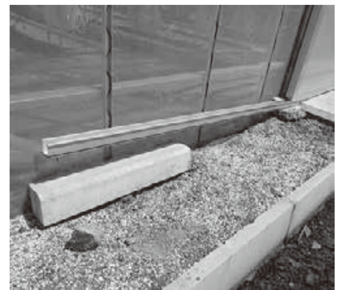
地盤沈下したいちごハウス
