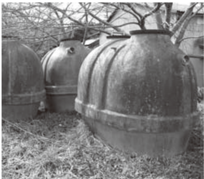
合併処理浄化槽
